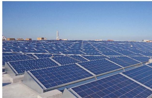
河南信阳25MW
